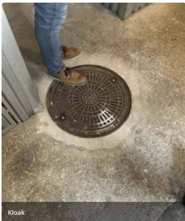
Afløbsdæksel i kældergulv
